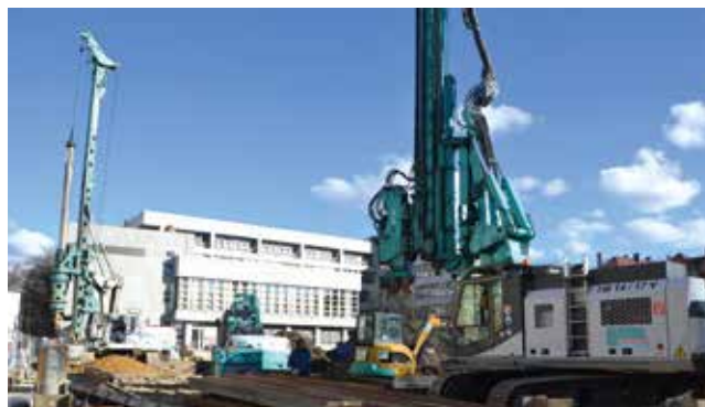
Schweres Gerät in der Fallstraße 34. Die Bauarbeiten für das Wohnbauprojekt der KZVB begannen im November 2015.
