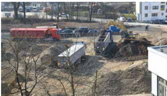
Kontaminiertes Erdreich, das gesondert abtransportiert werden muss, führt zu Verzögerungen. Die Rendite wird sich dadurch nicht signifikant verändern.
